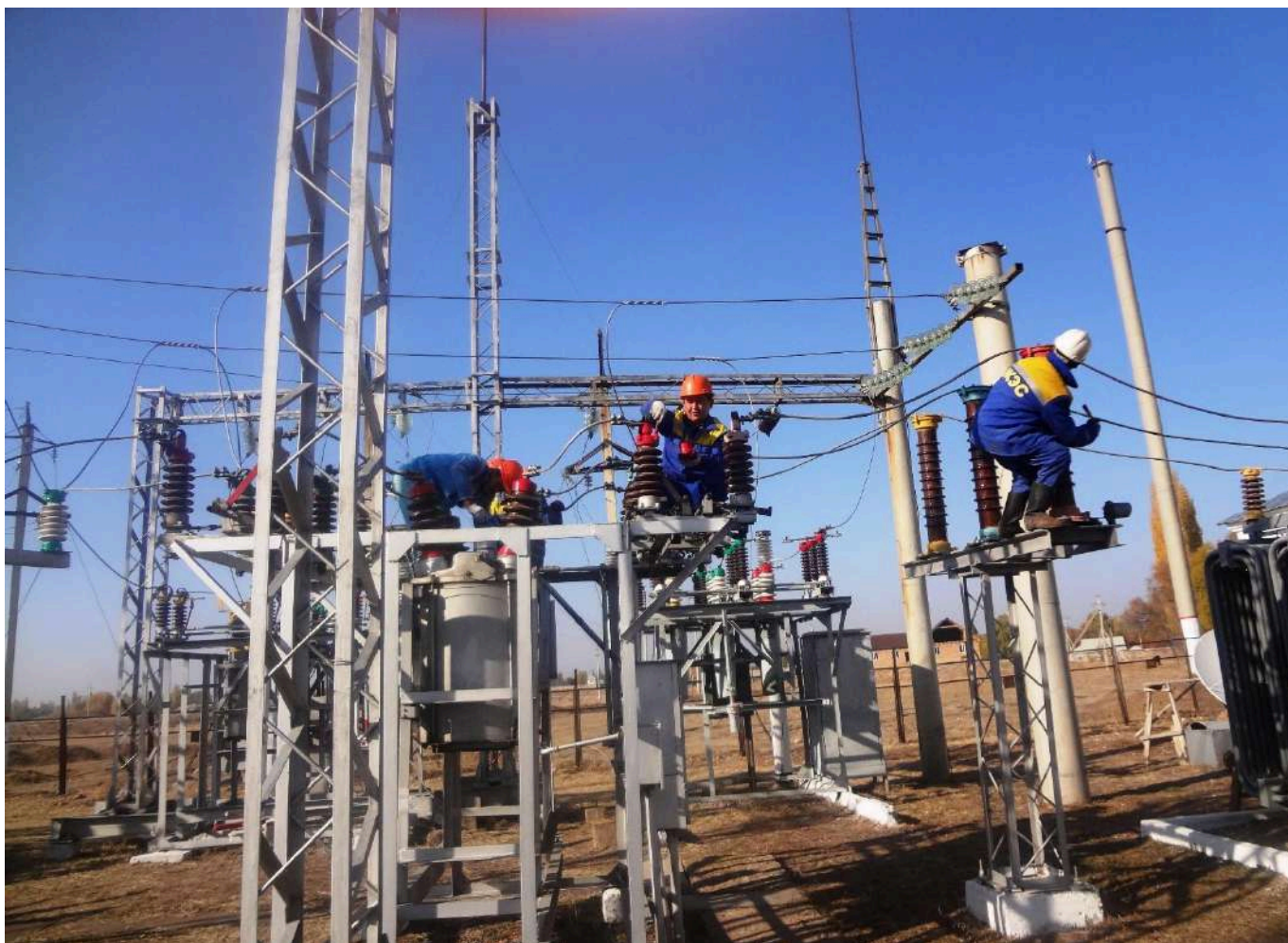
На снимке: Электрослесари ТОО «Жамбылские электрические сети» при выполнении работ на ОРУ-110 подстанции 110 кВ.
