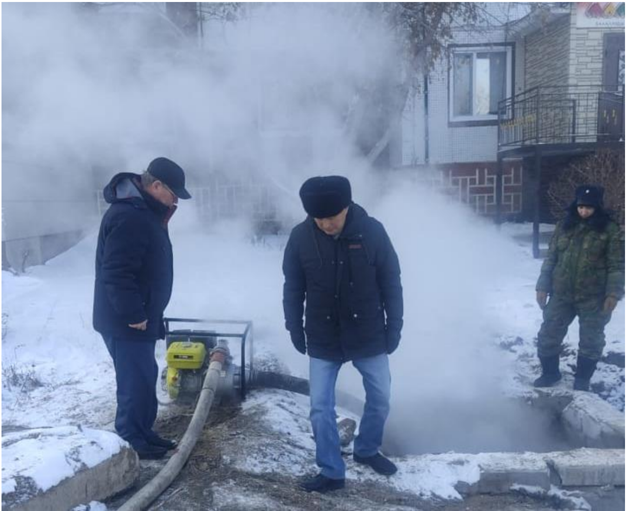
На фото: оттаивание вентилей на трубе
